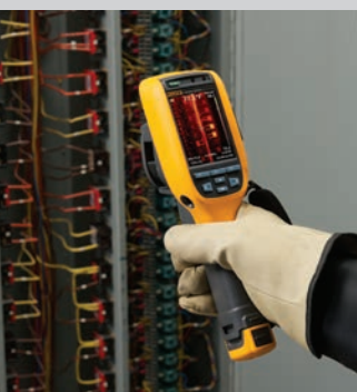
Inspeccione componentes eléctricos.
